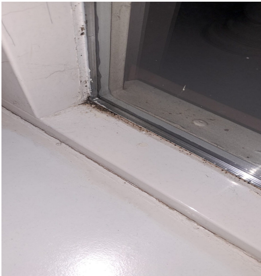
Foto 5. Slechte staat van kozijnen
