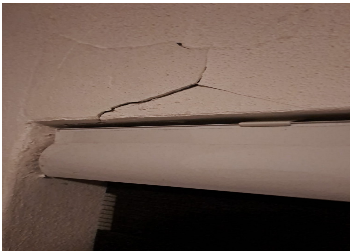
Foto 4. Scheuren in de wanden van de woningen
