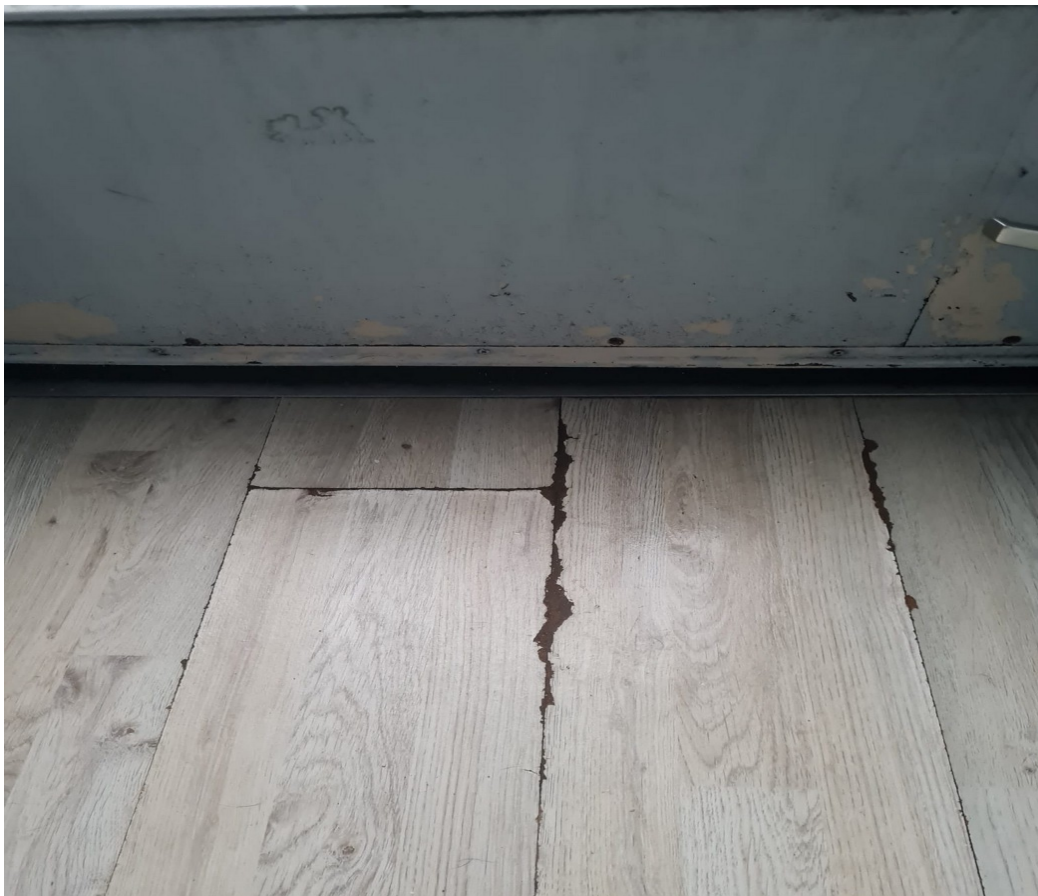
Foto 9. Vloerdelen die instabiel zijn
