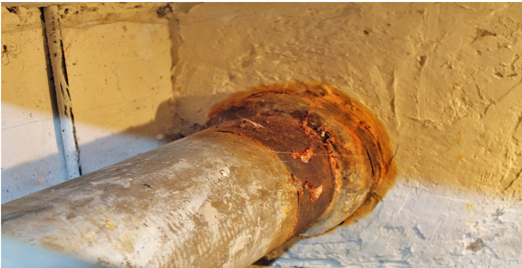
Foto 8. Asbesthoudende omhulsels rioleringsbuizen
